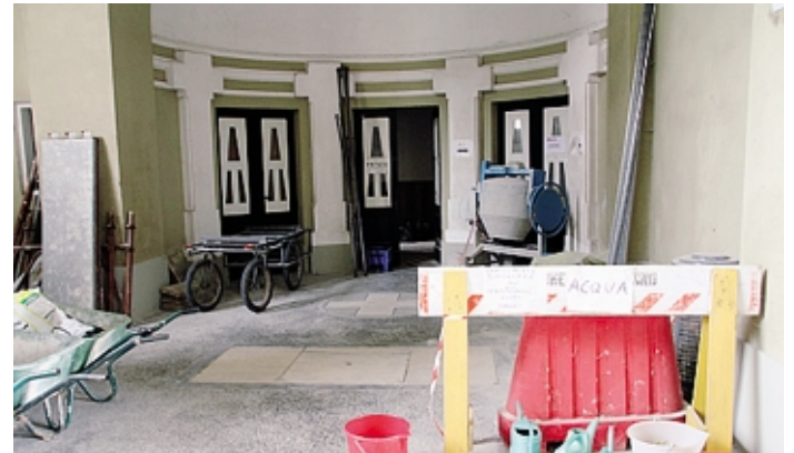
Stop temporaneo ai lavori al camposanto per le infiltrazioni dal soffitto
